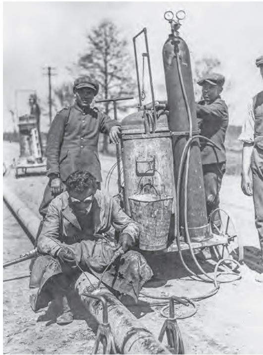
Spawanie gazociągu. Ekipa spawaczy i pomocników wynajęta przez Gazolinę z firmy Kozłowski ze Lwowa
