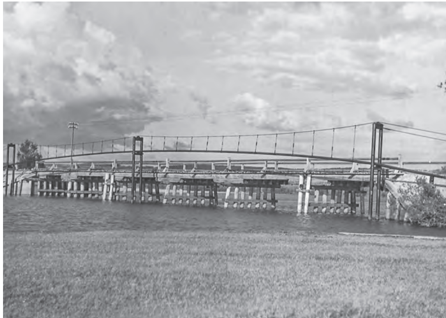
Most linowy dla podwieszenia gazociągu na rzece Dniestr niedaleko Rozwadowa Źródło: Archiwum Brwinów
