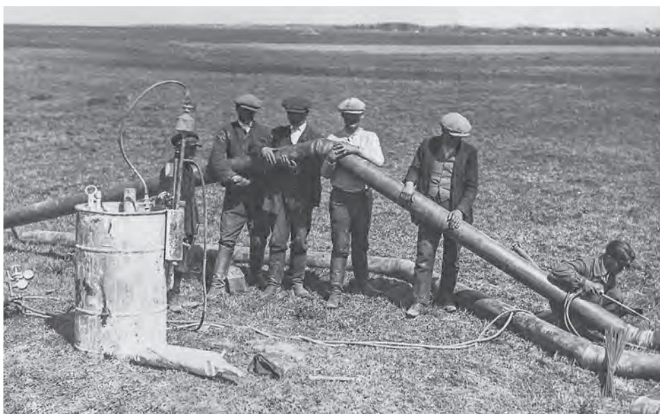
Układanie gazociągu. Ekipa spawaczy i pomocników wynajęta przez Gazolinę z firmy Kozłowski ze Lwowa
